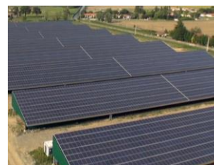
Ferme solaire de Seysses (31)
